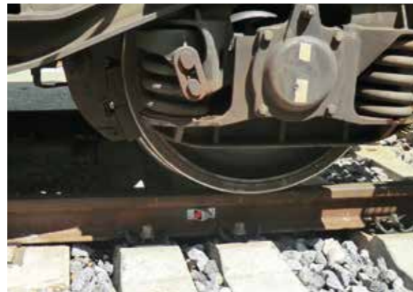
RSMP15, utilisé pour des mesures par une station totale robotisée, sous charge.
