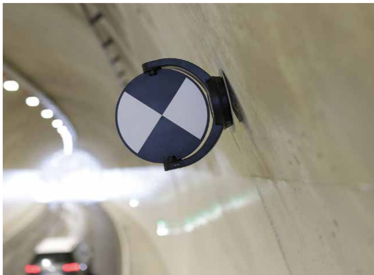
La marque de scanner laser RSL422M dans le tunnel
