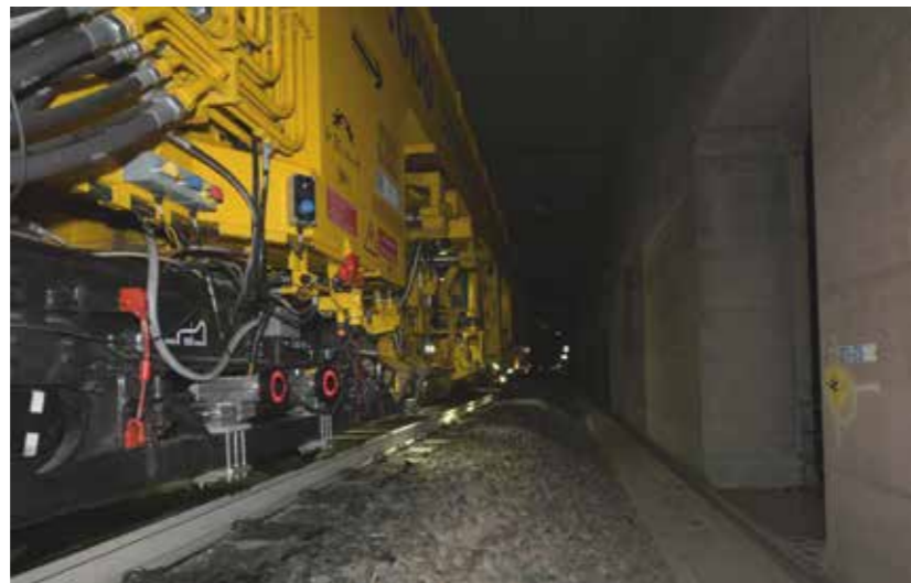
Système RPM installé sur la bourreuse-nivelleuse Unimat Combi 08-275 (RFI Italia)
